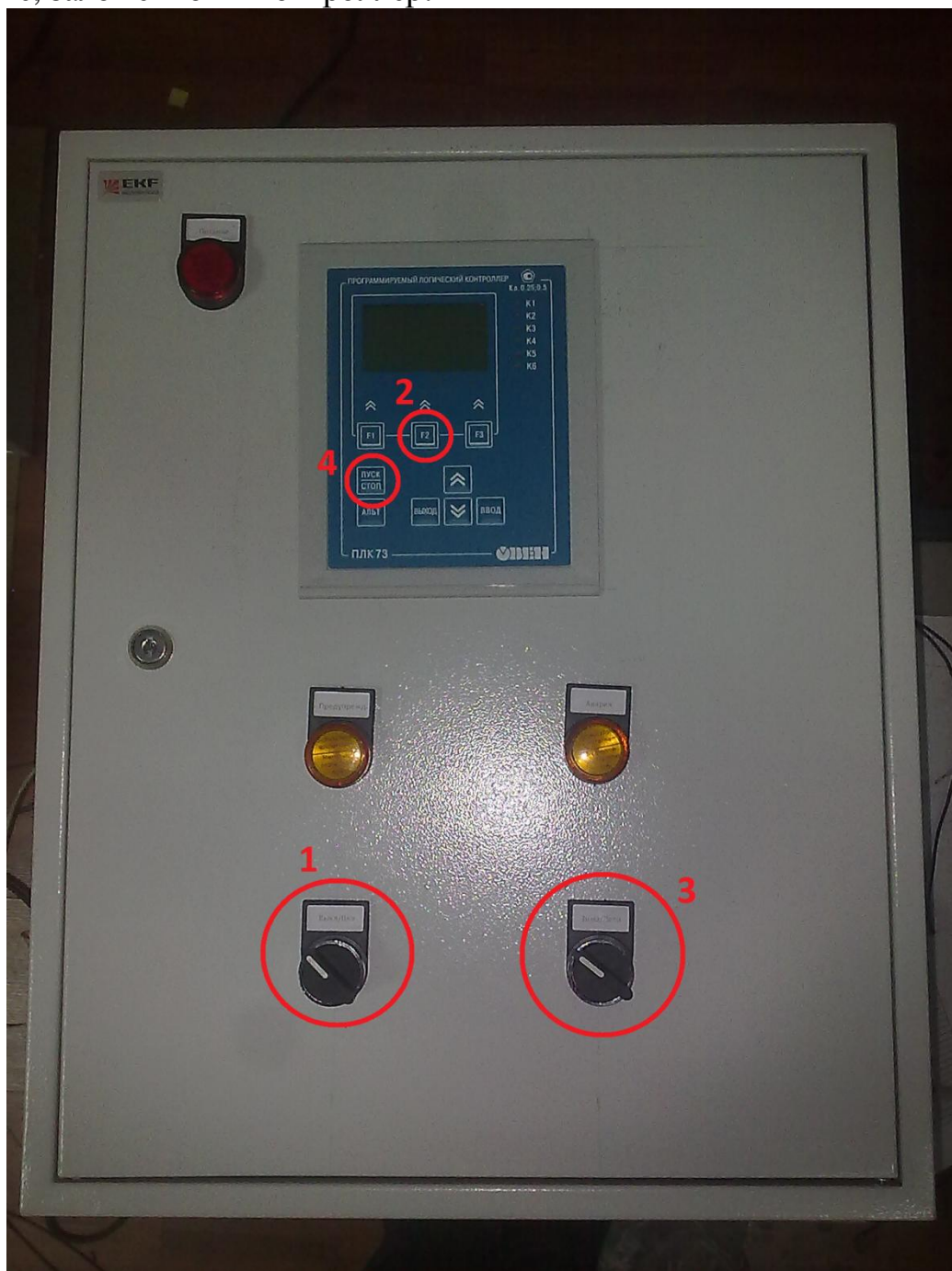
Рис. №1. Внешний вид шкафа.
