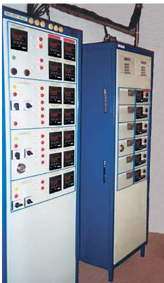
Фото. Шкафы управления системы ПОИСК-ТЕПЛО
