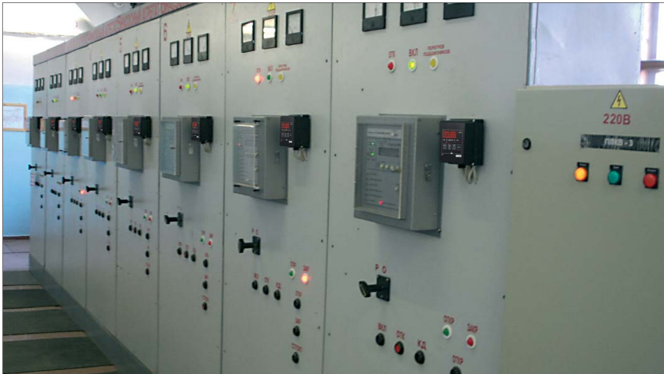
Фото. Станция управления на Филёвской КНС
