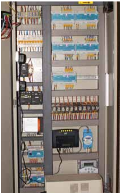
Фото 2. Шкаф диспетчерского контроля ЦТП
