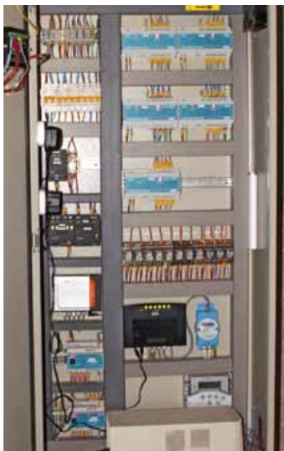
Фото 2. Шкаф диспетчерского контроля ЦТП
