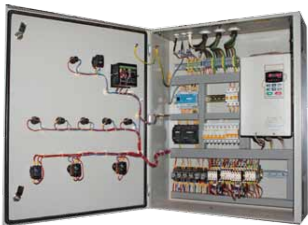
Фото 1. Шкаф автоматики насосной станции
